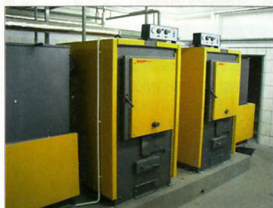
Kotłownia 2 x 104 kW – Szkoła Podstawowa w Białym Borze k. Koszalina
