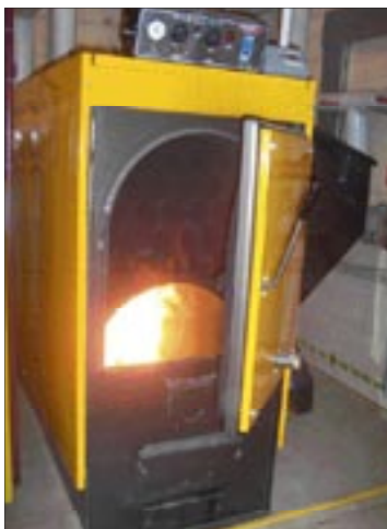
Kotłownia 128 kW – Dom Kultury Świt w Warszawie
